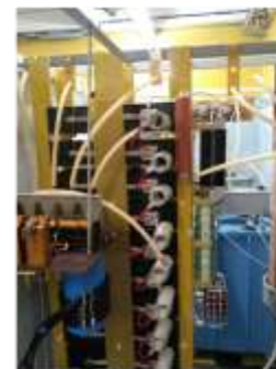
Высоковольтное оборудование источника питания
