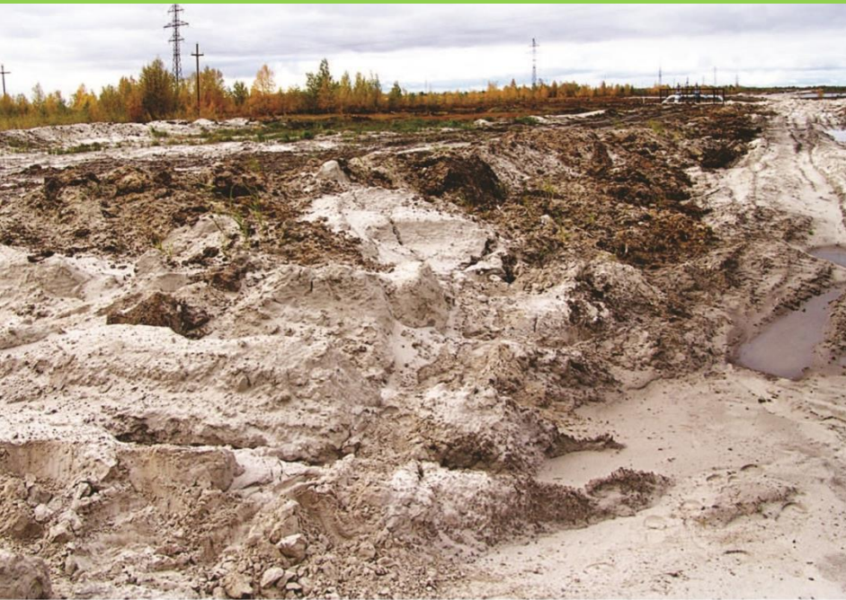
Перемещенный песок с торфом, оставленный после строительства дороги.
