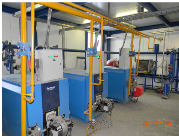
Рис. 7. Автоматизированная газовая котельная на площадке Ботанического сада ИБПК СО РАН
