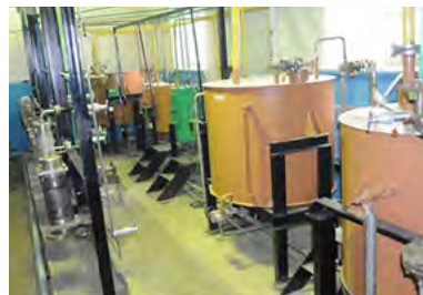
Укрупненная установка очистки жидких НАО на ФГУП «Горно-химический комбинат»
